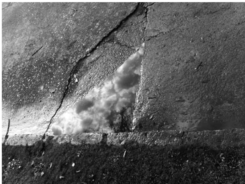
Figura 2. Poza de agua interviene la continuidad de la calzada de la calle Hernando de Aguirre, vereda poniente. 80 cm. ancho x 105 cm. largo. Registro: 7 de julio 2018, 10:05 hrs. © Ángela Ramírez.
