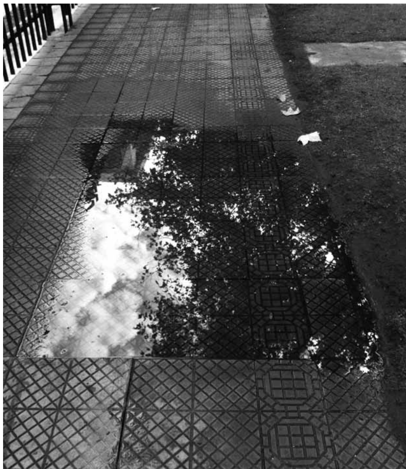
Figura 1. Poza de agua interviene la continuidad de la calzada de la calle Hernando de Aguirre, vereda poniente. 150 cm ancho x 250 cm largo. Registro 18 de junio, 2018, 9:45 hrs. ©Ángela Ramírez.
